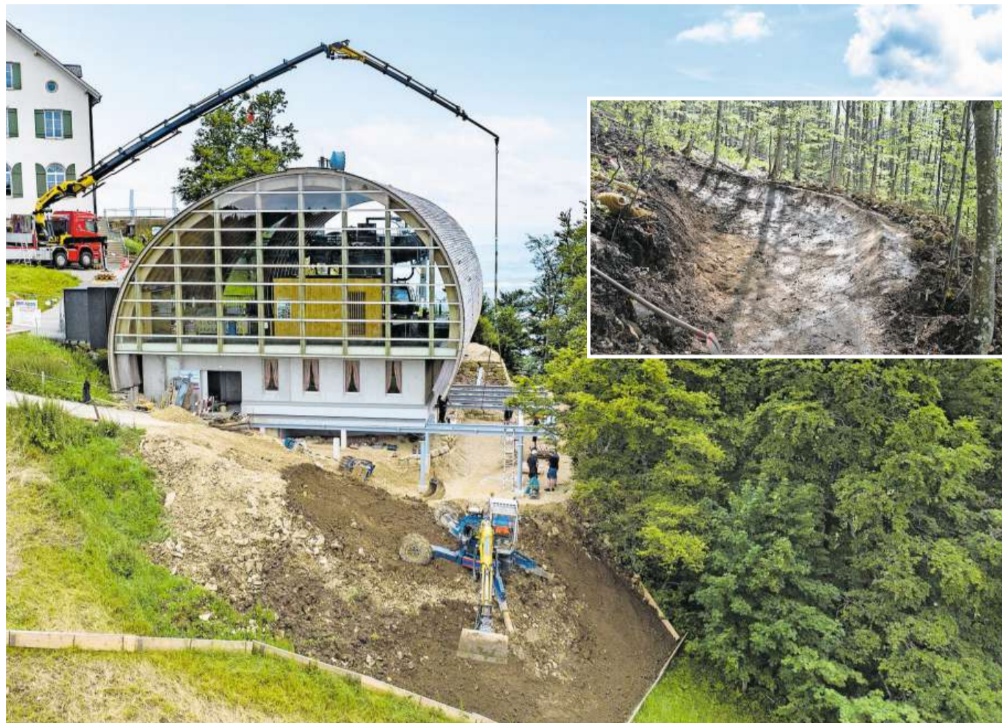
Bauarbeiten für den Startram der neuen Bikestrecke bei der Bergstation der Seilbahn Weissenstein.
